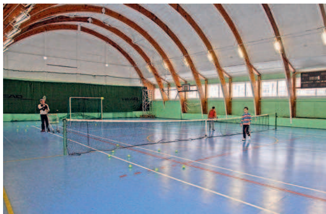
ФОК (ул. Юбилейная, 5) – единственное спортивное сооружение в районе Заозёрном. На ремонт из местного и областного бюджетов, а также резервного фонда губернатора израсходовано около 10 млн рублей.
