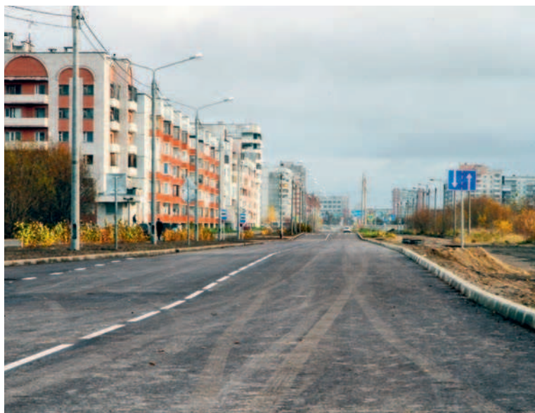
Почти 25 лет горожане, живущие по соседству с этой частью проспекта Победы, ждали благоустроенную дорогу.
